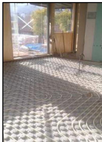
Figura 3.18: Sistema de Calefacción Fuente: Archivo Fotográfico Casa Pomaret
